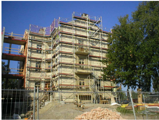
Echafaudage de pied ou posé
