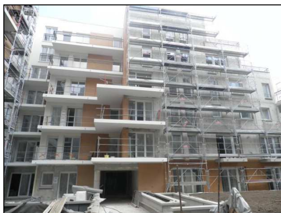
R 408 Prévention des risques liés au montage, à l'utilisation et au démontage des échafaudages de pied
