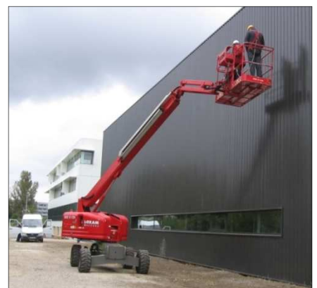
R 386 Utilisation des plates-formes élévatrices mobiles de personnes (PEMP)
